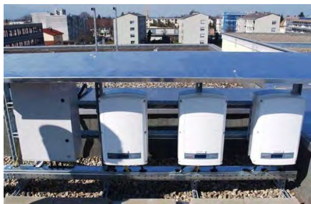
Fig. 39 - Inverter e quadri di campo posizionati su apposite strutture metalliche di sostegno.
