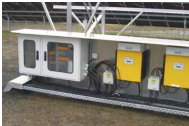
Fig. 38 - Inverter e quadri di campo posizionati al di sotto delle strutture a sostegno dei moduli.
